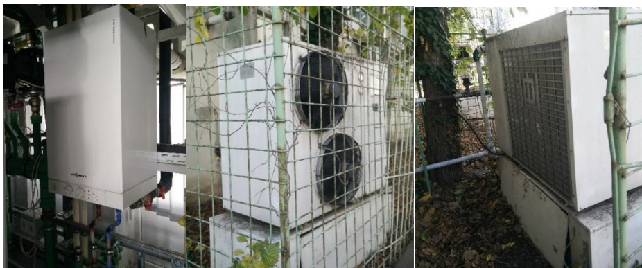
Figure 12: Echipamentele (cazan și chiller) ce încălzesc sau răcesc camera climatică
