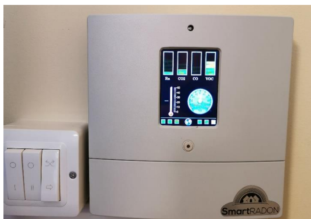
Figura 12 - Echipament prototip de monitorizare continuă din proiectul SMART_RAD_EN
