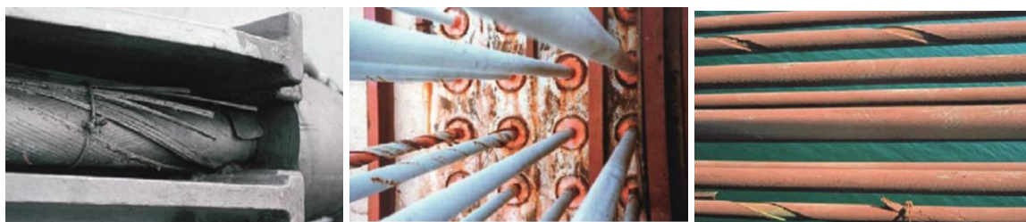
Figura 2 – Vătămări ale hobanelor
