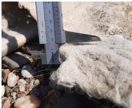
Fig.7.6. Geotextil afectat de plutitori
