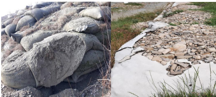
Fig.7.4. Degradarea prin vandalism, tăierea sacilor și incendiere
