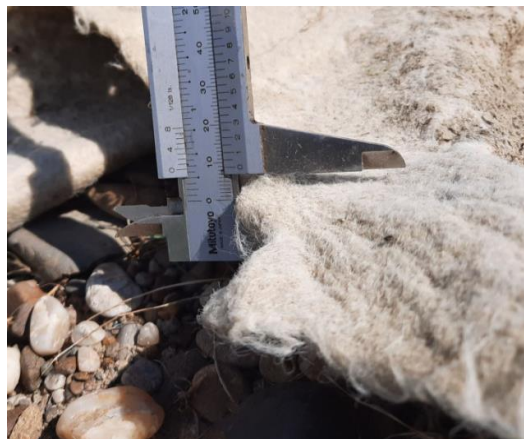
Fig.7.6. Geotextil afectat de plutitori
