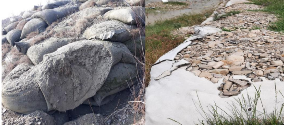
Fig.7.4. Degradarea prin vandalism, tăierea sacilor și incendiere
