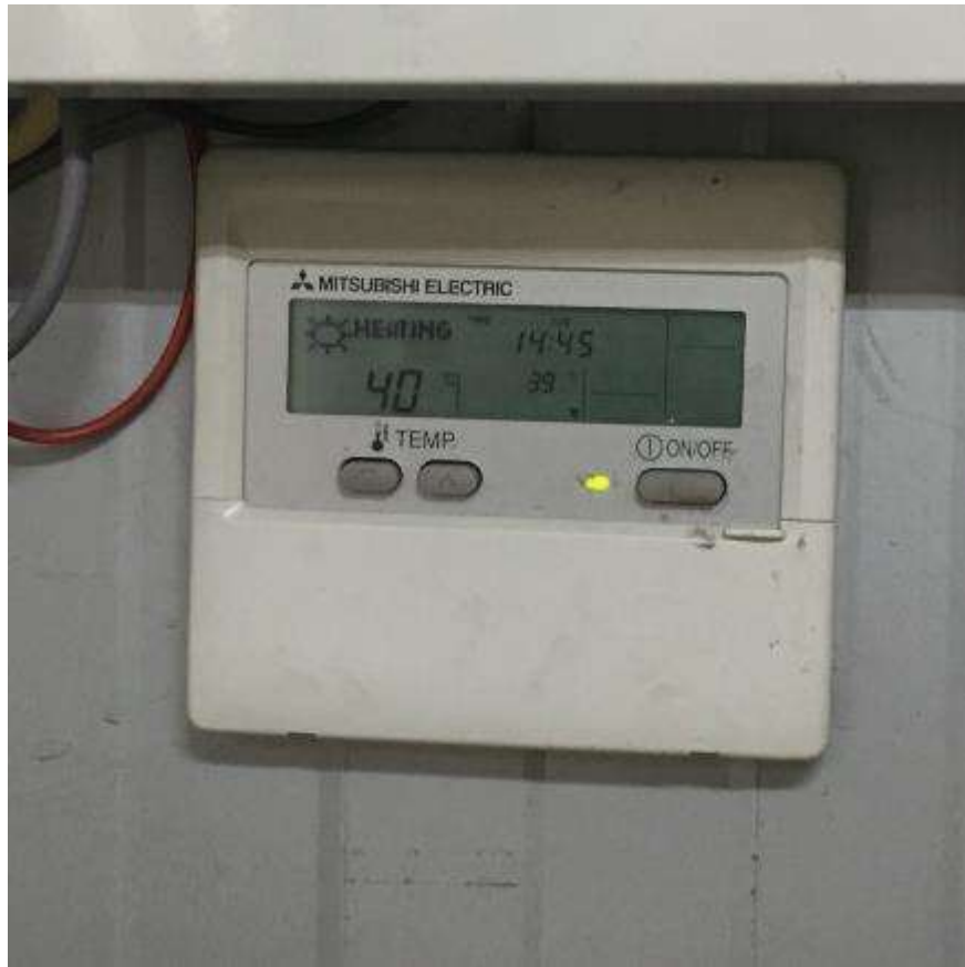
Figura 44 controllerul de temperatura al pompei de caldura
