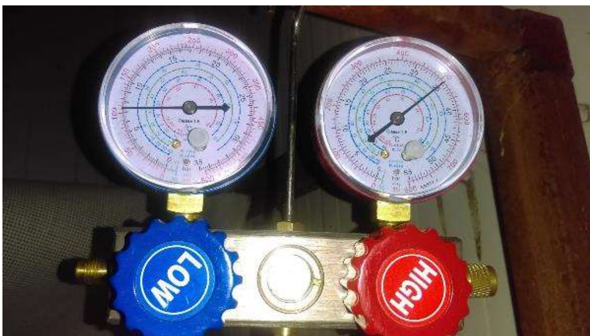
Figura 57 exemplu de presiuni si temperaturi corespunzatoare citite pe manometre
