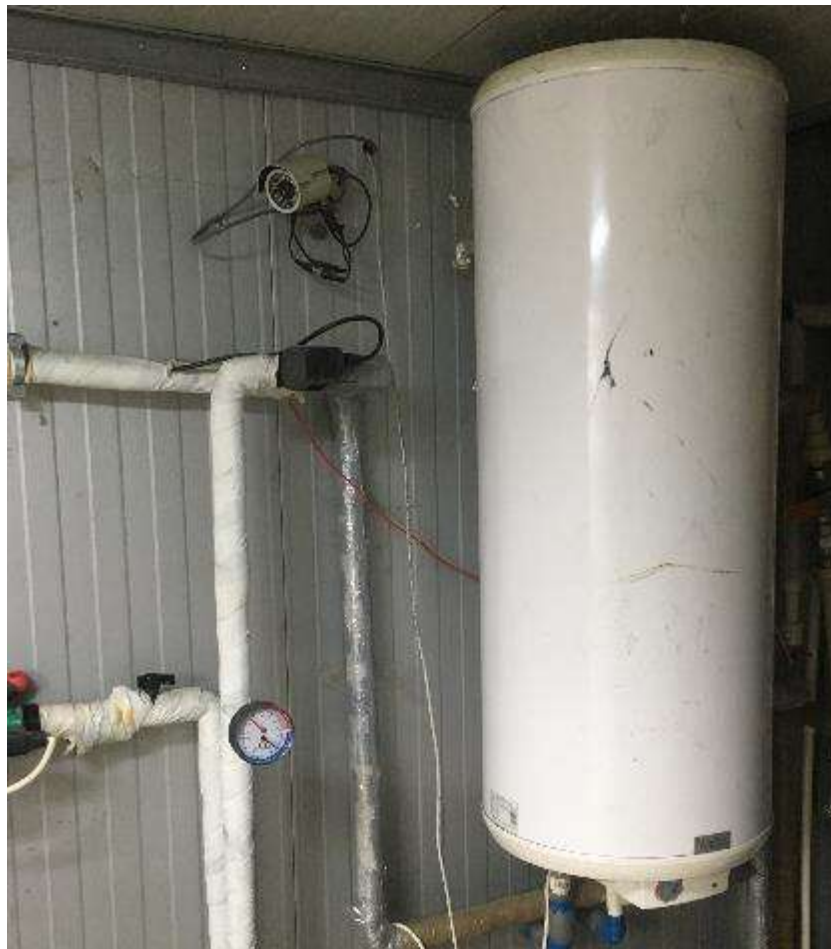
Figura 42 Valva cu 3 cai si boilerul de apa calda de consum.
