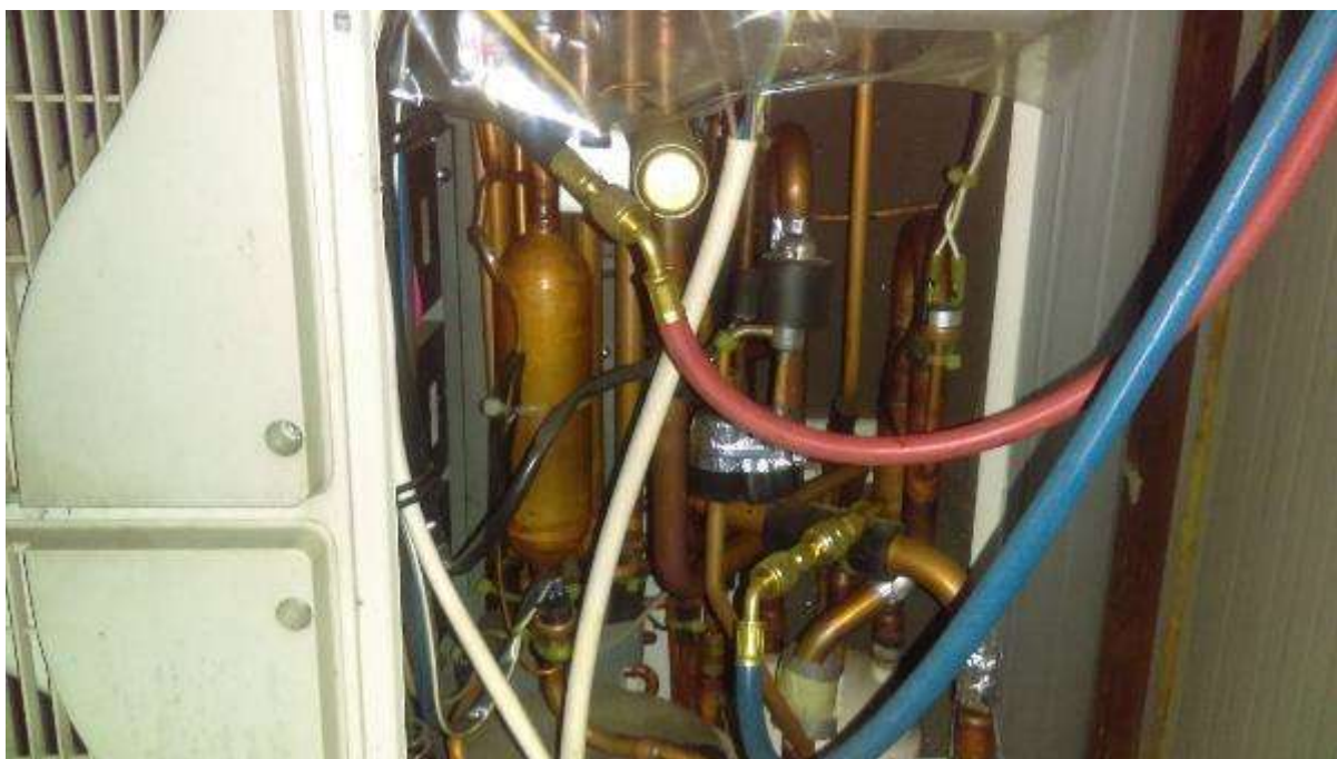
Figura 56 instalarea manometrelor pe liniile de intrare si iesire in compresor
