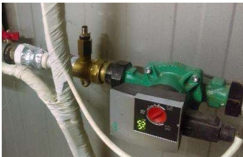
Figura 46 pompa de recirculare pe circuitul secundar al schimbatorului de caldura
