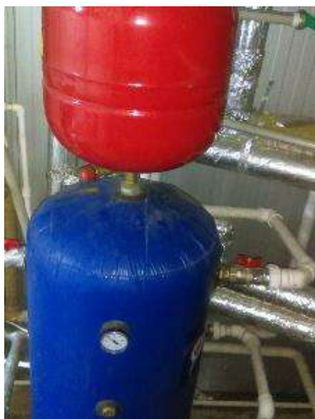
Figura 43 Bateria de amestec, albastru si vasul de expansiune, rosu
