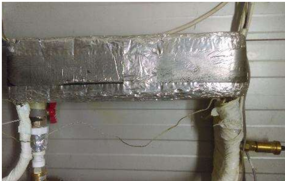
Figura 45 schimbatorul de caldura in placi, condensatorul pompei
