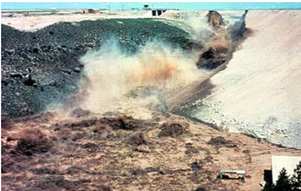
Figura 7. Fotografie a barajului Teton: în apropierea amiezii, scurgerea s-a extins și mai mult și s-a lărgit sub creast, [7].
