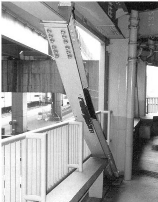
Fig. 1. 24 Flambajul diagonalei cu secțiune „I” în afara planului cadrului , în urma cutremurului de la Kobe 1995 [3]
