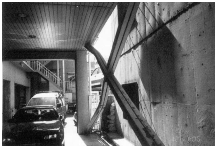
Fig. 1. 25 Flambajul diagonalelor unui cadru contravântuit în sistem „X”, în urma cutremurului de la Kobe 1995 [3]
