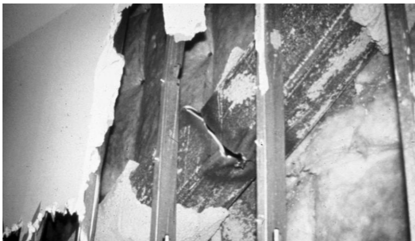
Fig. 1. 21 Diagonală din țevă rectangulară, cedată în urma cutremurului de la Northridge 1994 [3]
