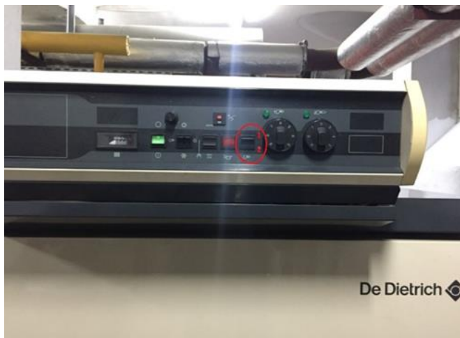
Fig.40 a) Condiții de funcționare b) panoul de comandă al cazanului T1-etapa1 / T2-etapa2
