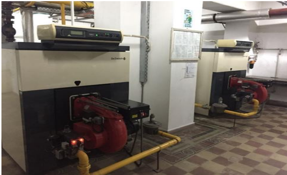
Fig.37 Centrala termica la interior
