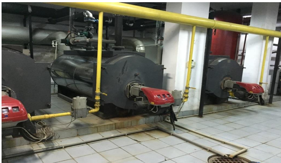
Fig.26 Centrala termica la interior
