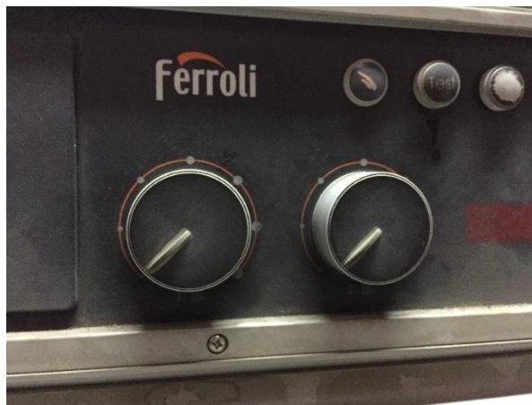
Fig.29 a) Condiții de funcționare b) panoul de comandă al cazanului T1-treapta1 / T2-treapta2 /
