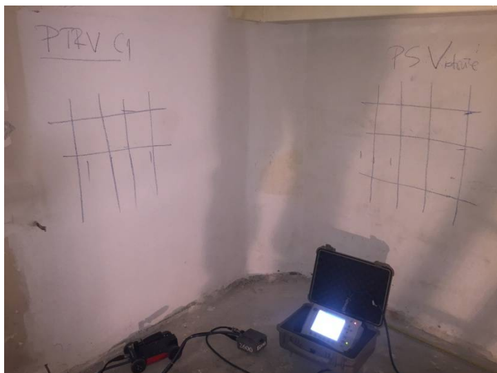
fig .4.1.1.cladire interbelica bucuresti afectata de umezeala-studiu georadar
