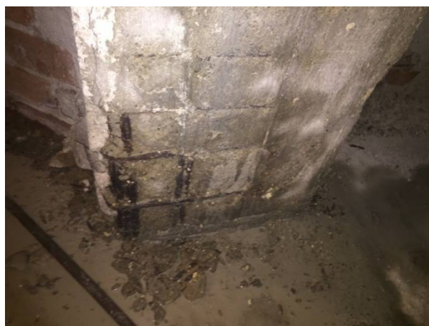
fig 4.2.1 . Cladire 1938 cu stalpi subsol 50x50 cm la care acoperirea cu beton a fost expulzata de armaturile ruginite .CAUZA : lipsa tencuiala protectie stalp
