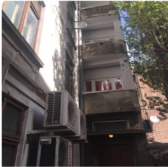
fig.2.9.4 Defect de conformare cladirea CALEA MOSILOR -cladiri realizate fara rost intre ele si cu degradari rezultate .
