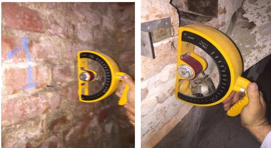
fig.4.2.3 .Cladire 1920 cu zidarie subsol afectata de umezeala pe termen lung :
