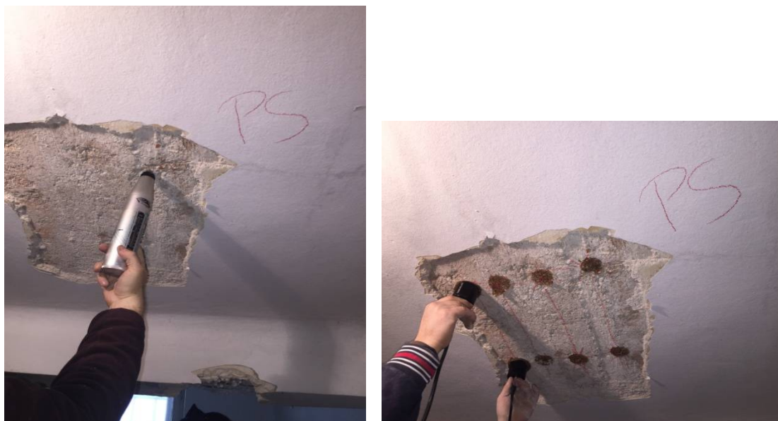
fig.2.13 inspectie vizuala la decopertare planseu beton armat si teste ultrasunete si sclerometrie -se observa si masoara micro-fisuri
