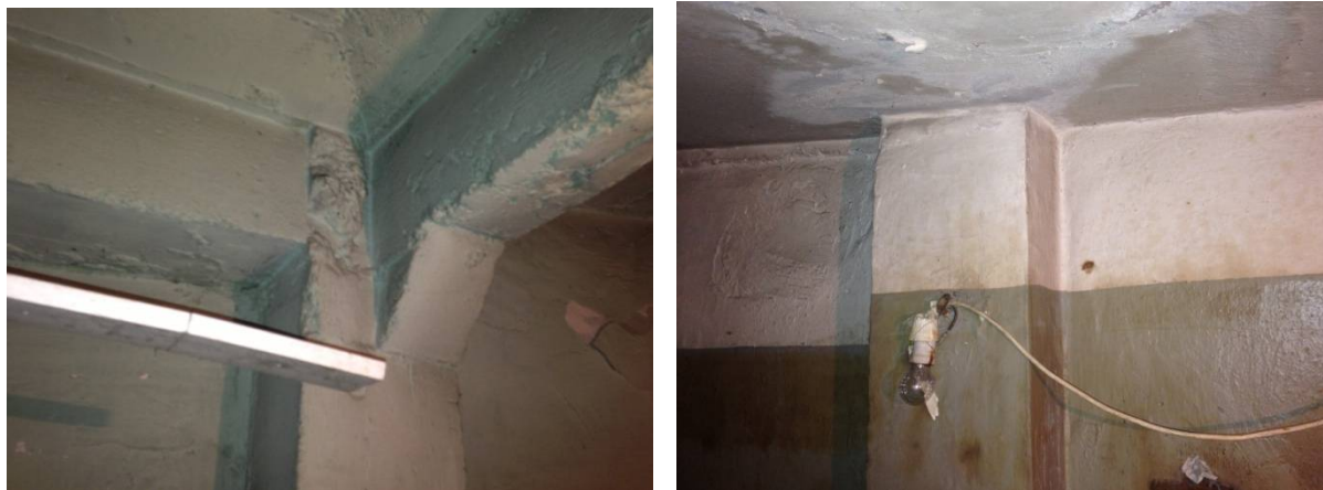
fig.2.11 inspectie vizuala imobil bd. .FERDINAND-BUCURESTI-degradari din lipsa hidroizolatiei
