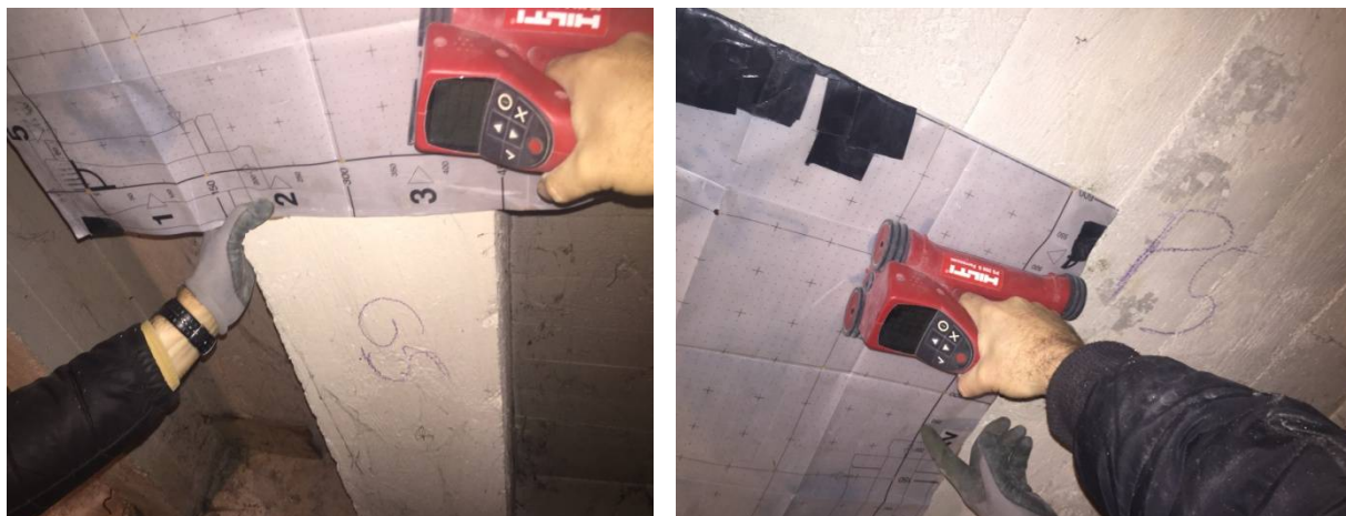
fig.2.4.relevu structura orizontala beton armat (grinzi si plansee ) realizat cu GEORADAR GSSI-1GHZ
