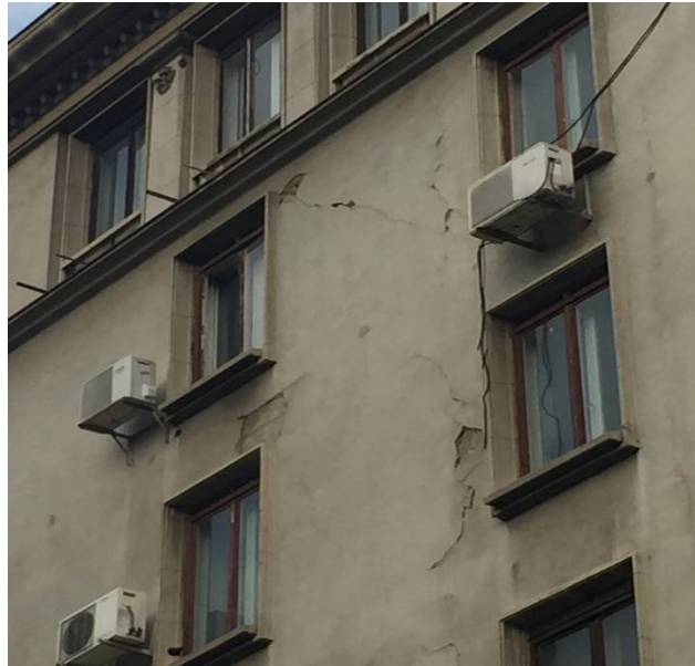
fig .4.1.3 .degradari din seism zidarie - fisuri si crapaturi in forma de "x" pe spaletii de zidarie datorita deplasarilor mari ale cladirii si subdimensionarea structurii in cadre proiectata la nivelul anului 1935
