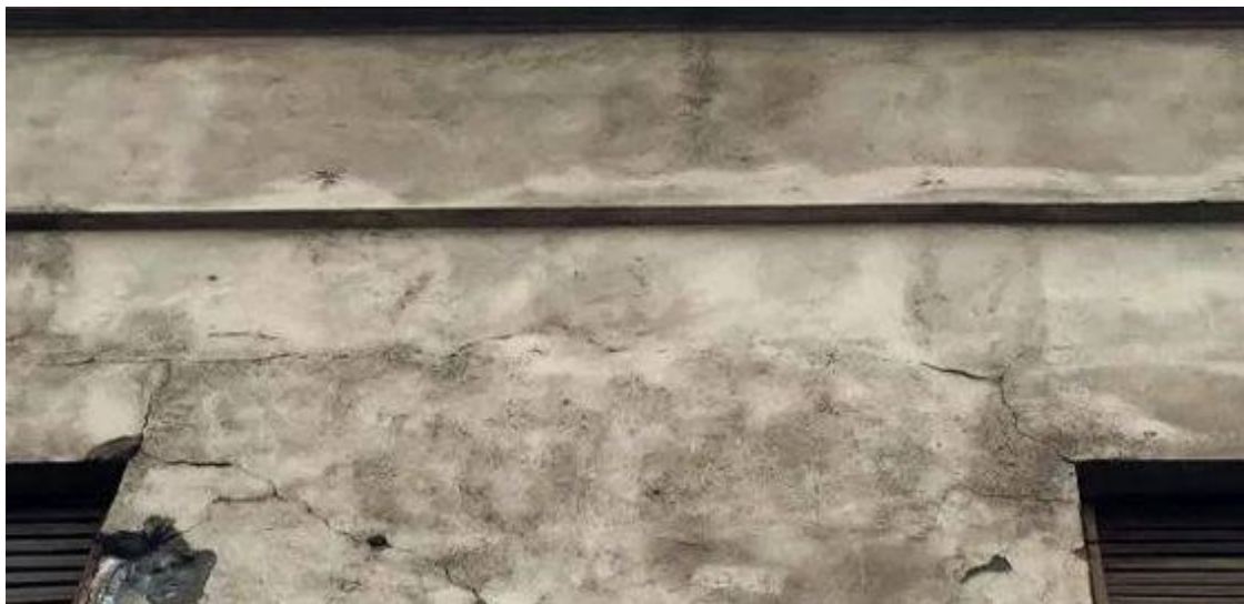
fig .4.1.4 .degradari din seism zidarie - fisuri si crapaturi in forma de "x" pe spaletii de zidarie datorita subdimensionarii acestor pereti
