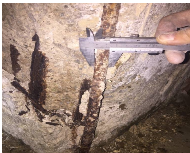
fig 4.2.2. Cladire cu stalpi subsol 30x30 cm la care acoperirea cu beton a fost complet distrusa de mediul acid datorat explatarii CAUZA : lipsa tencuiala protectie stalp .
