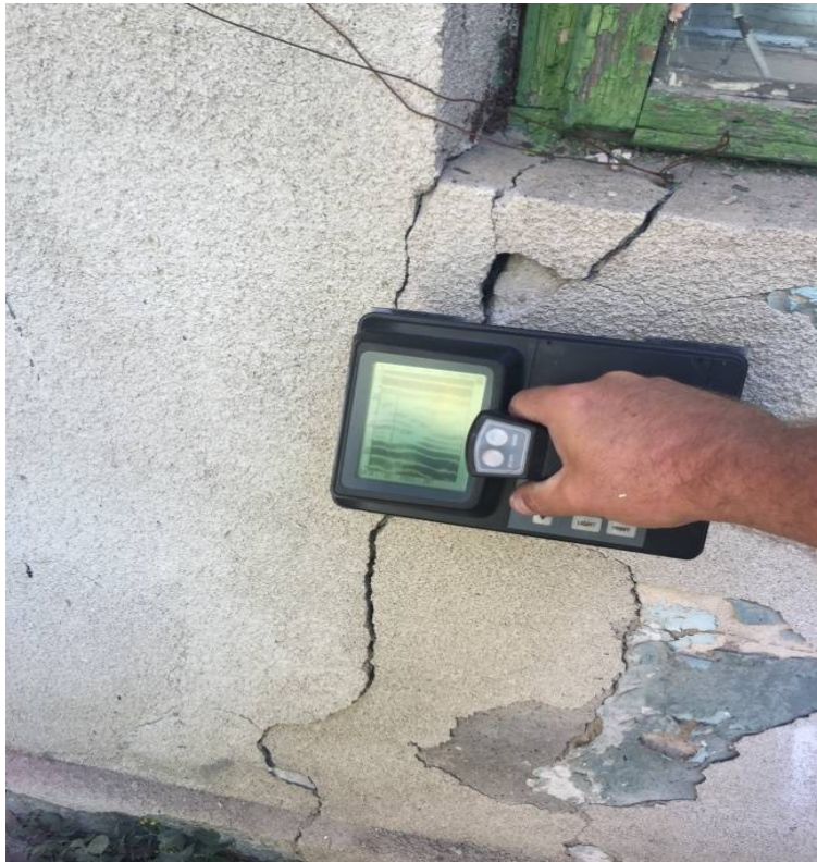
fig.2.10 inspectie vizuala si cu georadar fisura pereti zidarie cpp
