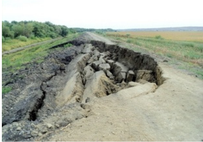
Figura 1. Prăbușirea în fundație a digului (Expertiza tehnică – “Consolidarea digului și închiderea breșei în localitatea Isaccea, Județul Tulcea”)
